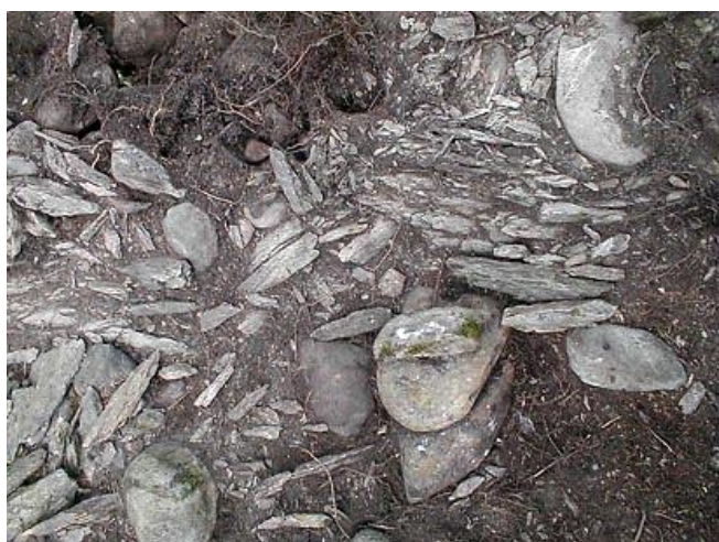
Schegge sottostanti il manufatto
